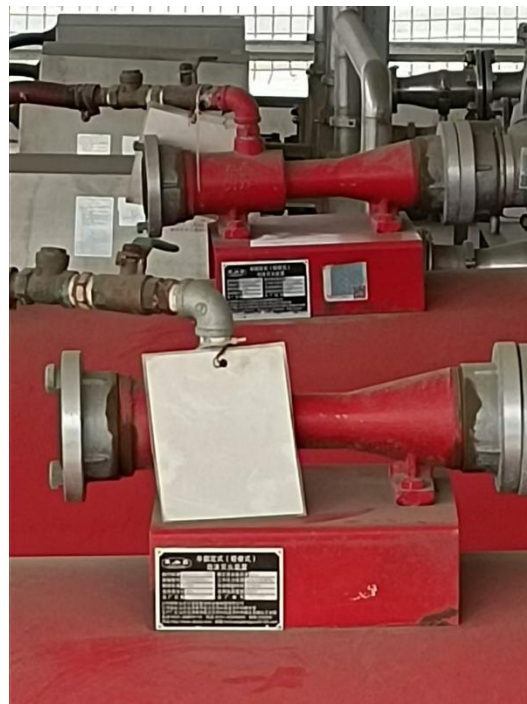
乙醇罐区泡沫灭火器
